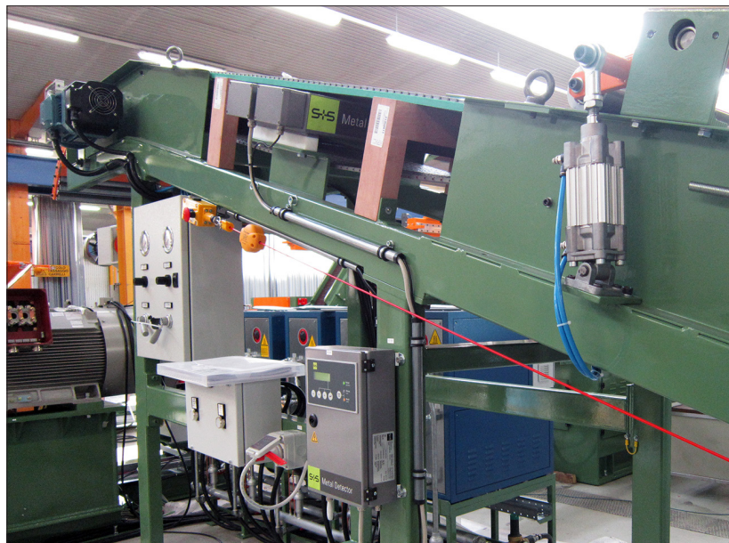
Flächen-Metalldetektor des Typs ELS eingebaut unter dem Zuführförderband in einer Anlage von Marangoni Meccanica S.p.A.
